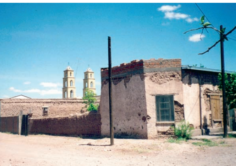
Abandono y alteración de la arquitectura tradicional de Casas Grandes, Chih
