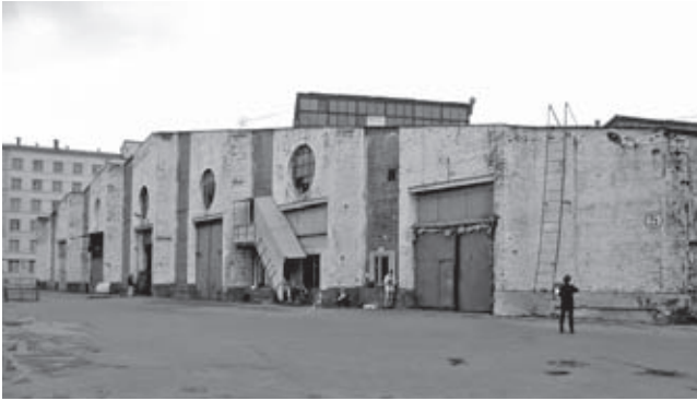
Бахметьевский Автобусный парк, ул. Образцова 19. 1926–27 г., арх. К. С. Мельников. Задний фасад. Состояние 2002 г
