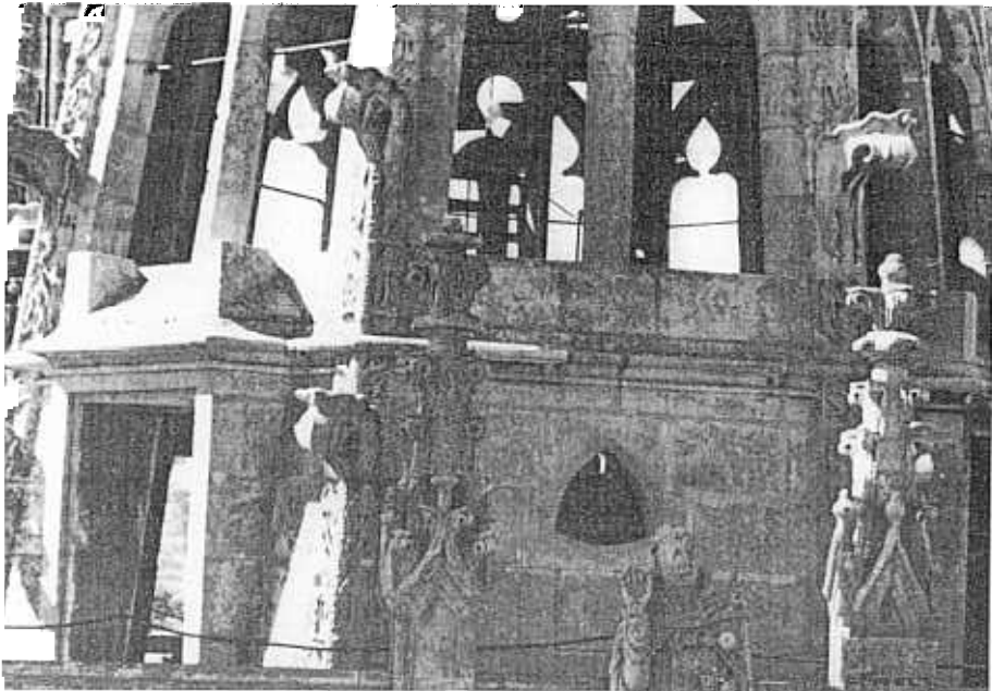
Fig. 2 - Burgos. Cathédrale. Cette tour a été consolidé avec un revêtement de béton armé. A l'intérieur il y a plus d'espace que dans l'autre tour, renforcée avec des poutres en fer laminé. C'est le procédé le meilleur. Chaque pierre est fixée de façon à former un complexe monolithe.
