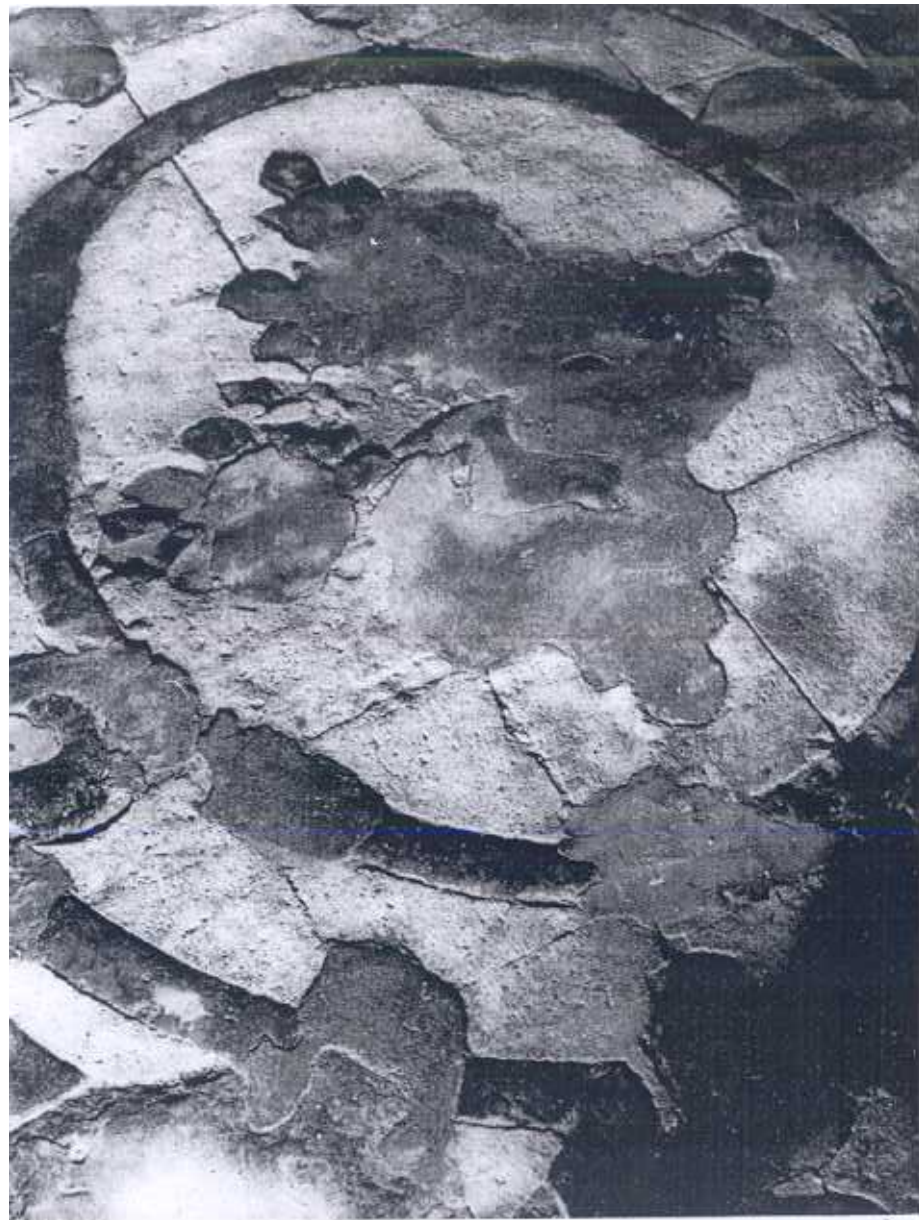
Fig. 5 - Particolare della zona anteriore del pavimento prima dei restauri. Si osservano i gravi danni prodotti dalla usura secolare ed i successivi rattoppi con cemento.
