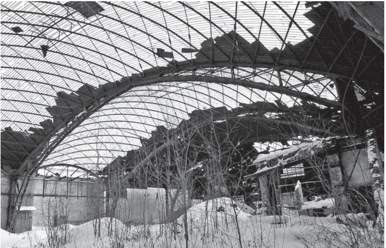
Покрытие прокатного цеха металлургического завода в г. Выксе Нижегородской области, выполненное В. Г. Шуховым в 1897 году в виде оболочек двоякой кривизны (современное состояние)
