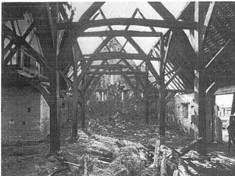
2. Interior looking south, after the fire Intérieur vers le sud, après l'incendie
