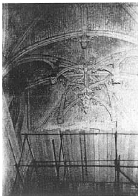
Fig. 5 - St. Jacques du Tréport. Etat de la voûte avant les travaux.
