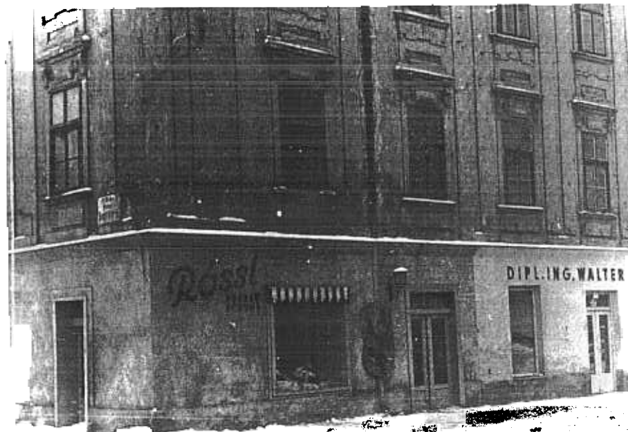
Fig. 9. - Humidité remontée à l'étage par l'application d'un enduit imperméable au rez-de-chaussée.
