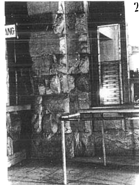
Fig. 25. - Vienne, Gare du sud. Eclatement des blocs de calcaire de Karst.
