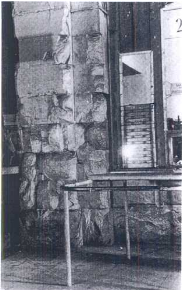
Fig. 25. — Vienne, Gare du sud. Eclatement des blocs de calcaire de Karst.
