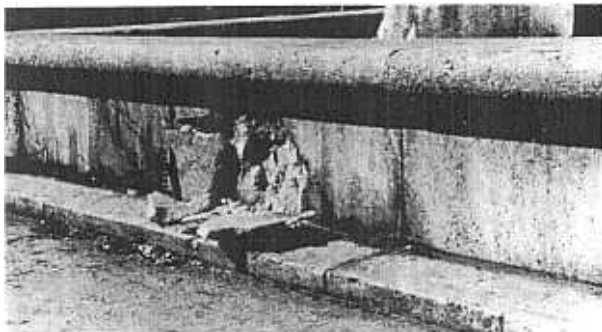
Fig. 4. — Bassin de fontaine en calcaire où le gel a fait éclater des morceaux de la pierre retrempée durant quelques années.
