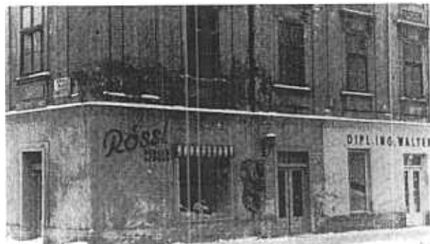
Fig. 9. — Humidité remontée à l'étage par l'application d'un enduit imperméable au rez-de-chaussée.
