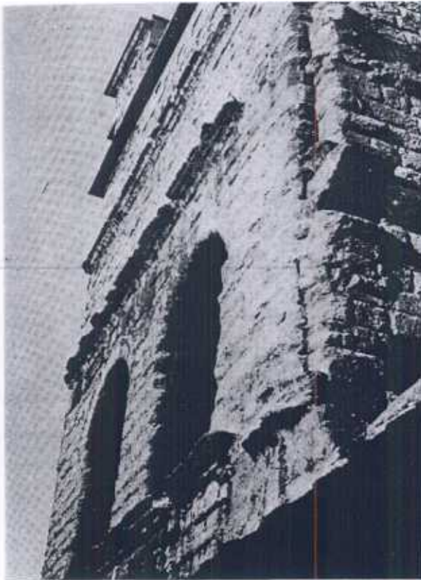
Fig. 1. — ORANGE (Vaucluse). Théâtre romain, façade O.-S.-O. Molasse feldspathique (Vindobonien). Erosion de surface. (Cl. Bertheliet).
