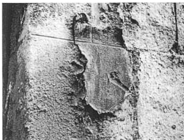
Fig. 10. — TOURS (I.-&-L.). Mur à la rue du Grand Marché. Lésion en plaque. (Cl. Krumbein).
