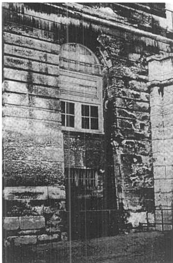
Fig. 8. — VERSAILLES (S.-&O.). Château, aile des Ministres. Lutétien du Bassin de Paris. En haut et à gauche, zone humide éventée : alvéolisation; en bas et à droite, zone humide déventée : lésion en plaque. (Cl. Berthelier).
