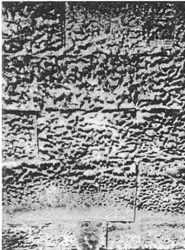
Fig. 5. — VERSAILLES (S.-&O.). Château, aile des Ministres. Alvéolisation en zone de montée d'eau du sol. Lutétien du Bassin de Paris. (Cl. Berthelier).
