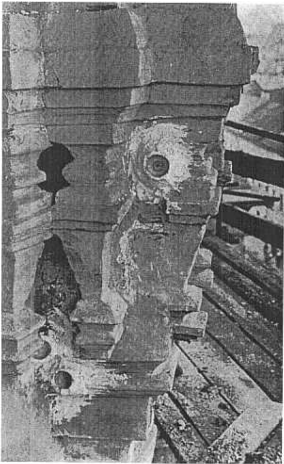
6. Rosettes moulées à la surface d'une maçonnerie.
