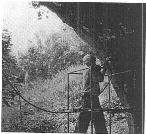
Fig. 8. — Injection dans la maçonnerie d'un ancien pont du parc Nescoutchny à Moscou.
