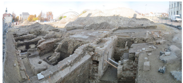
Nach Abschaffung des ungarischen Denkmalamtes steht der Beseitigung der Bastionen von Győr zugunsten einer Tiefgarage nichts mehr im Weg.
