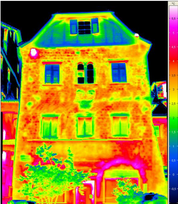
Waaghaus in Bozen/Italien, IR Thermographie, zeigt Schwachstellen in der Konstruktion wie Wärmebrücken und Durchfeuchtungen.
